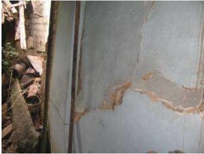
Fractura de muro interior de edificación Predio Carrera 7 Este No. 13 – 52/56 Sur. Fuente: Concepto Amenaza Ruina FOPAE - 2009
