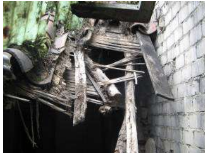
Colapso parcial de cubierta de edificación Predio Carrera 7 Este No. 13 – 52/56 Sur. Fuente: Concepto Amenaza Ruina FOPAE - 2009
