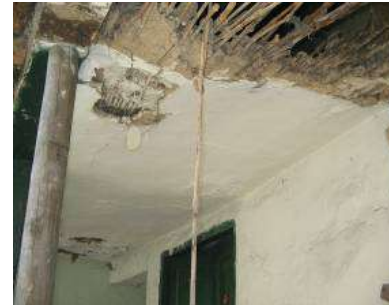
Colapso parcial de cielo-raso Predio Calle 3 No. 14 – 58 Fuente: Concepto Amenaza Ruina FOPAE - 2009
